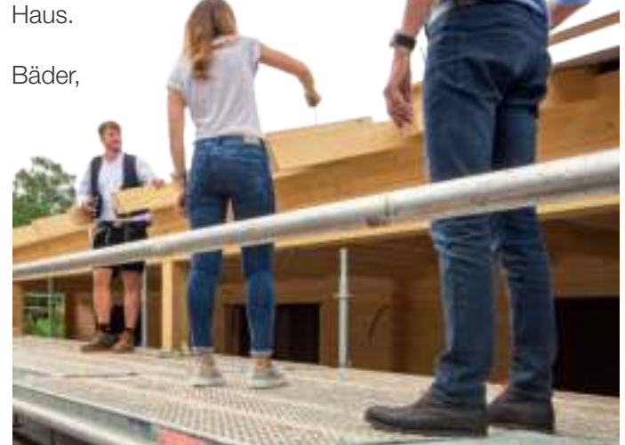
Eine Tradition, die auf keinem Richtfest fehlen darf: das Nageleinschlagen in das Gebälk des neuen Hauses.
